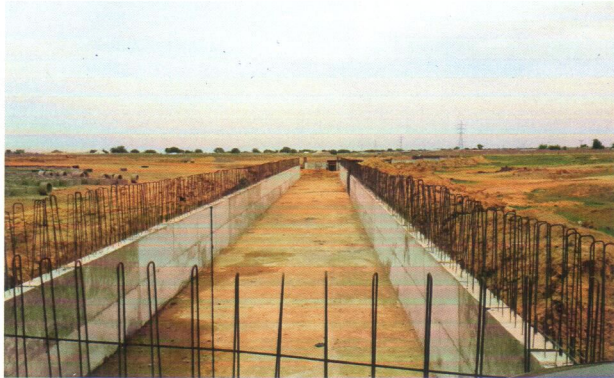
Water Canalization (KANO)
